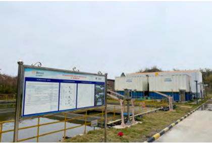
陆川水泥废水零排项目
